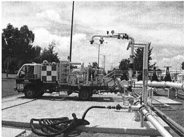
Figura 1. Vista lateral del punto de chequeo ubicado en la estación de combustibles.
