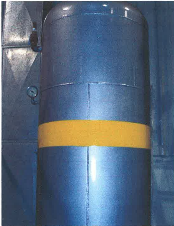
Fig. 13.- Tanque de control de sistema de aire de Baja Presión.
