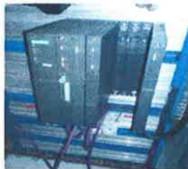
Fig. 4.- PLC serie 400 de Siemens, Fuente de Poder, CPU y Tarjetas.
