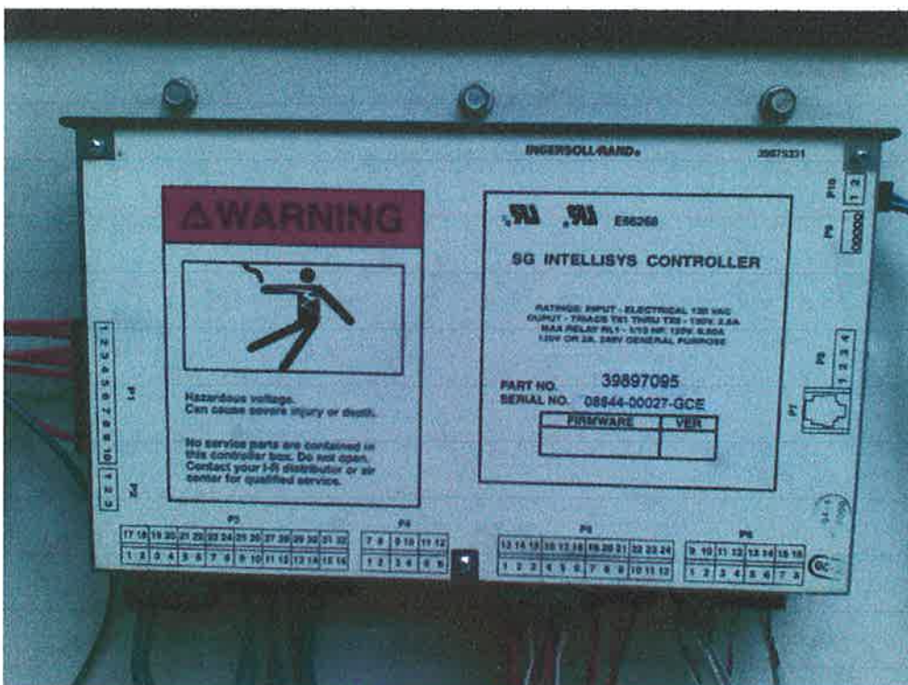
Fig. 7.- Distribución física de tarjeta en los tableros.
