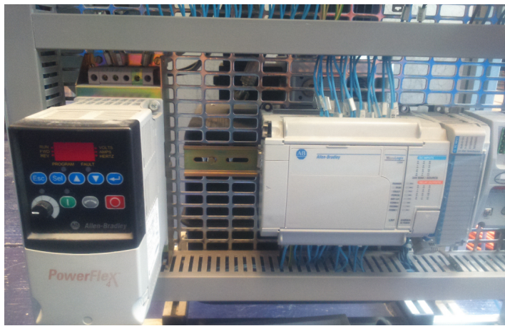
Figura 10. PLC y variador de frecuencia Powerflex, banco 2.
