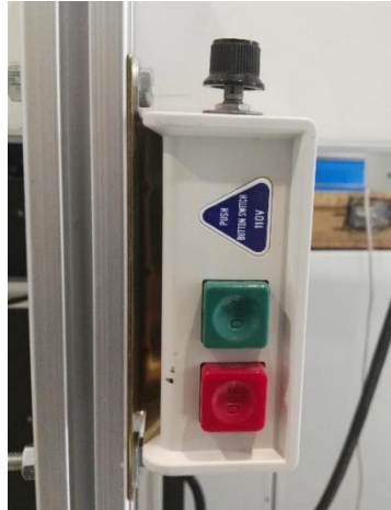
Figura 56 Variador de Velocidad Motor centrifugo.
