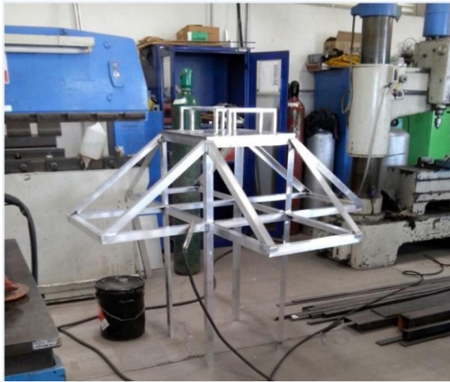
Figura. 38 Muestra la fabricación de la estructura superior de la Boya, los ángulos son de Aluminio de 1 1/2" X 1 1/2" X 1/8" para su fabricación.
