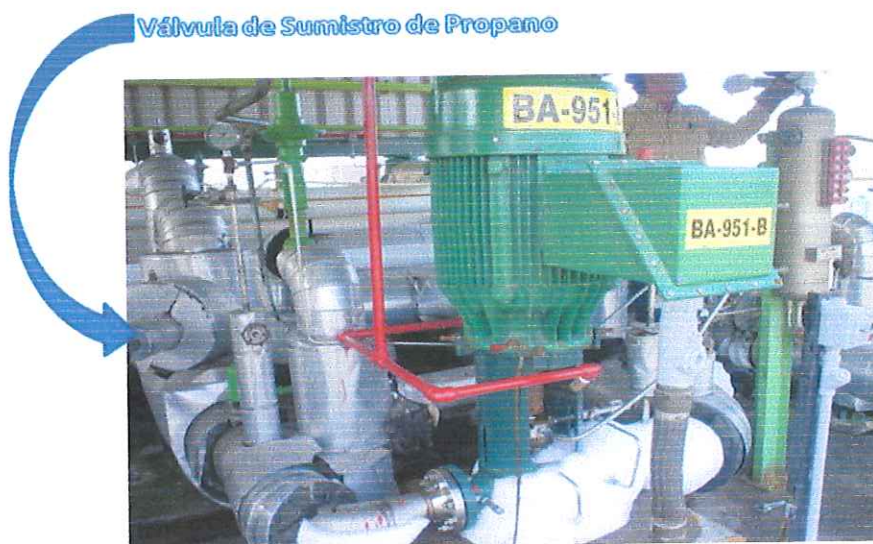
Figura 7.10. Bomba de Carga de Propano BA-951-B
