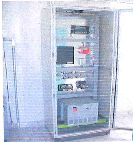
Figura 7.9. Cuarto de Control.
