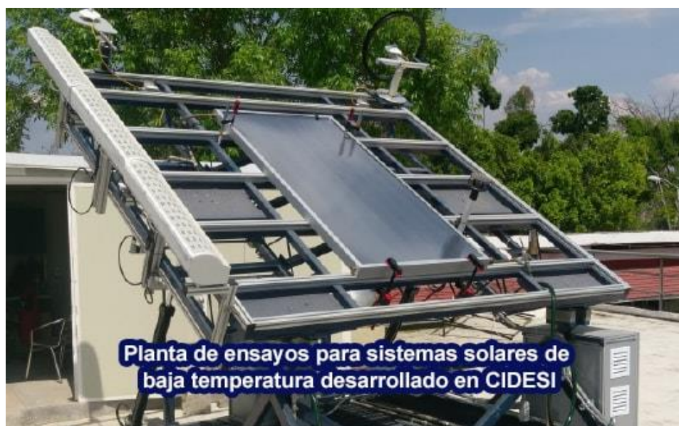
Figura 29. Estructura del montaje de pruebas a colector termo solar de CIDESI, sede Querétaro. Fuente: (Centro de Ingeniería y Desarrollo Industrial, s.f.)
